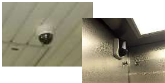
防犯カメラ（駅構内、エレベーター内）
