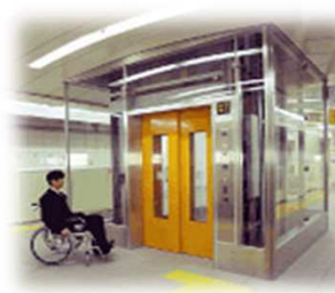
エレベーター
