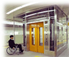
エレベーター
