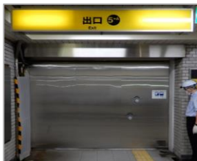
浸水対策（止水鉄扉）
