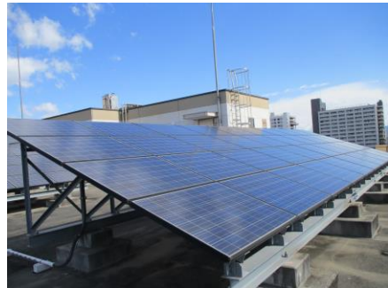
保有施設に設置している太陽光パネル
