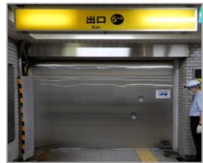
浸水対策（止水鉄扉）
