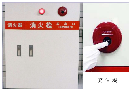
火災報知器・消火栓
