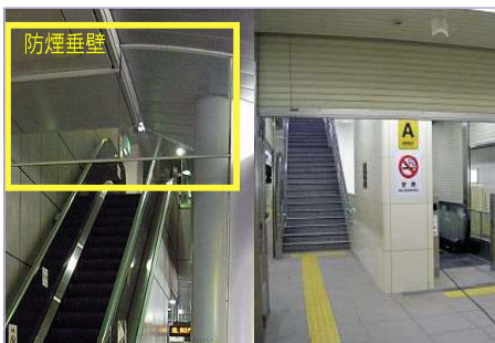
防煙垂壁・防火シャッター
