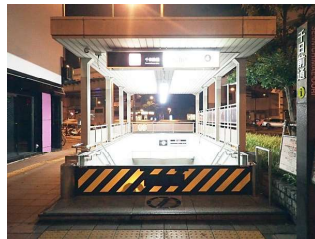
止水パネル設置例
