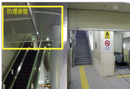
防煙垂壁・防火シャッター
