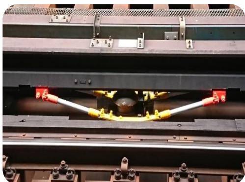
サードレール脱落防止
