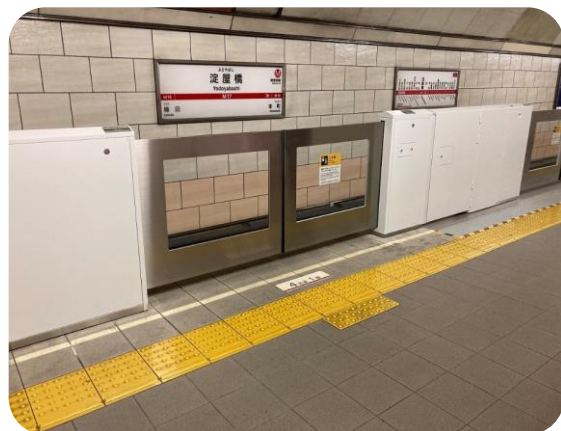
可動式ホーム柵（淀屋橋駅）
