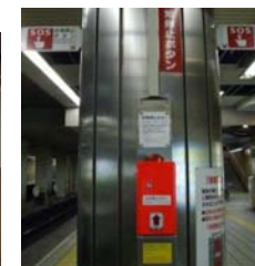
ホームの柱に設置
