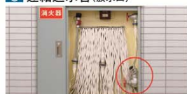
3 連結送水管(放水口)
