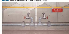
5 連結送水管(放水口)
