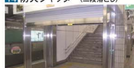
14 防火シャッター(二段落とし)
