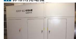
17 非常用発電機
