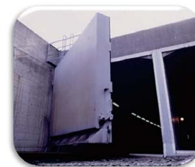
トンネル入り口止水扉 (大日検車場)
