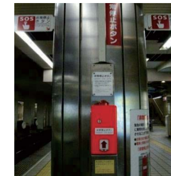
ホームの柱に設置
