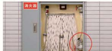
3 連結送水管(放水口)
