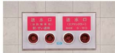
1 連結送水管(送水口)
