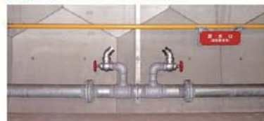
5 連結送水管(放水口)
