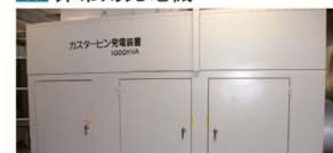
17 非常用発電機
