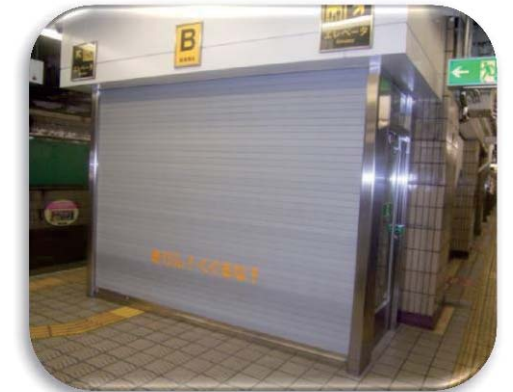
防火防煙シャッター
