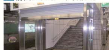
14 防火シャッター(二段落とし)
