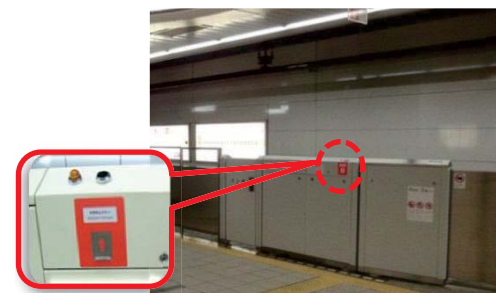
長堀鶴見緑地線と今里筋線はホーム柵に設置
