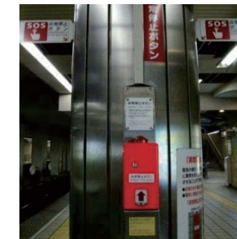
ホームの柱に設置
