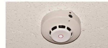
8 煙感知器(自動火災報知設備)
