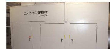
17 非常用発電機
