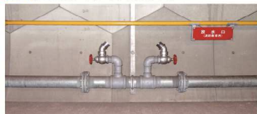
5 連結送水管(放水口)
