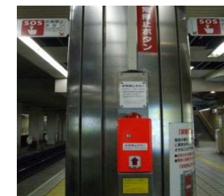
非常停止ボタン(ホーム)
