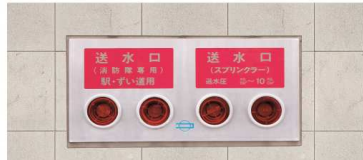
1 連結送水管(送水口)
