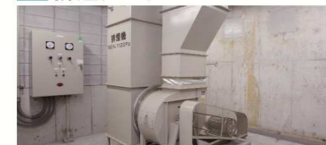
15 排煙システム
