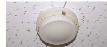
9 熱感知器(自動火災報知設備)
