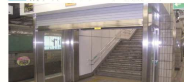
14 防火シャッター(二段落とし)
