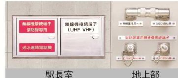
2 無線機接続端子
