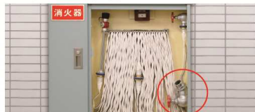
3 連結送水管(放水口)
