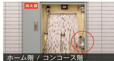
3 連結送水管(放水口)
