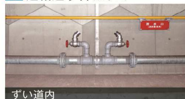
5 連結送水管(放水口)
