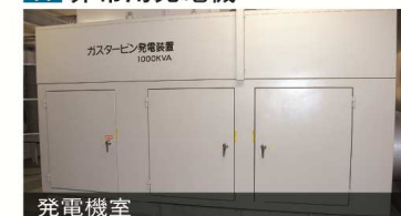
17 非常用発電機
