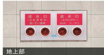
1 連結送水管(送水口)
