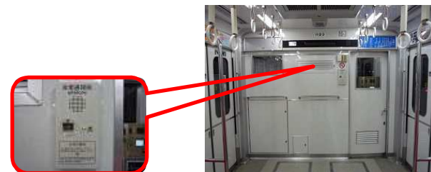
非常通報器(車内)
