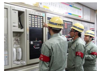
防災盤の点検
