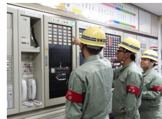
防災盤の点検
