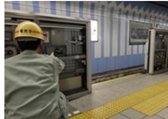
可動式ホーム柵の整備
